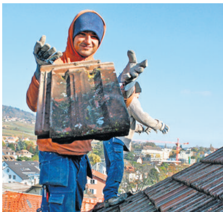
Juan Cruz Quirno Costa, apprenti couvreur sur le toit d'une maison rolloise. DR
